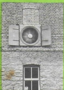
Bild 7 Stadelbelüftung in a) Stadel b) Westerdorf c) Langenfunzen
